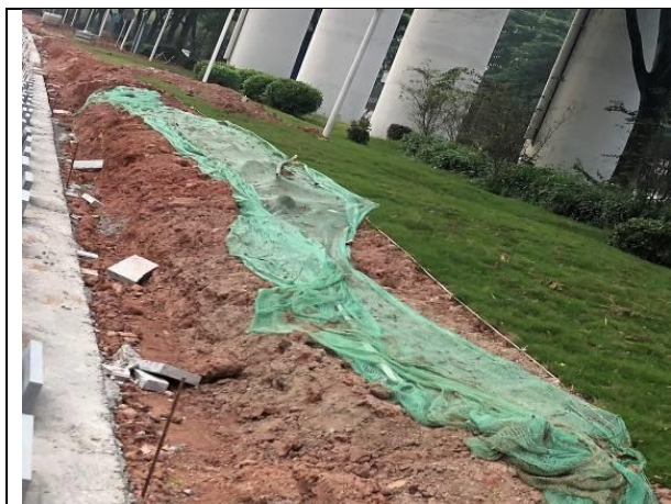
绿地改造区内裸露面现状 (2018.9)
