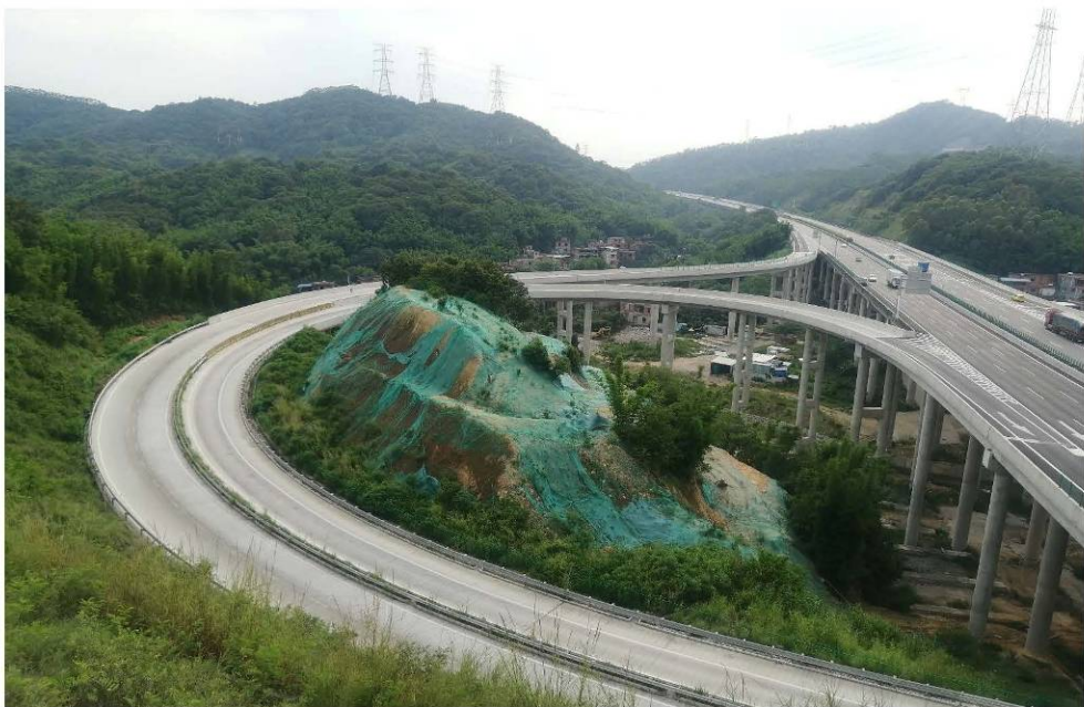
山体裸露，存在水土流失隐患
